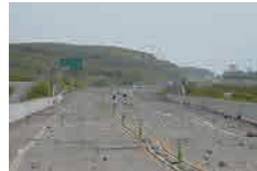
2000年有珠山噴火時の高速度道路被害状況
